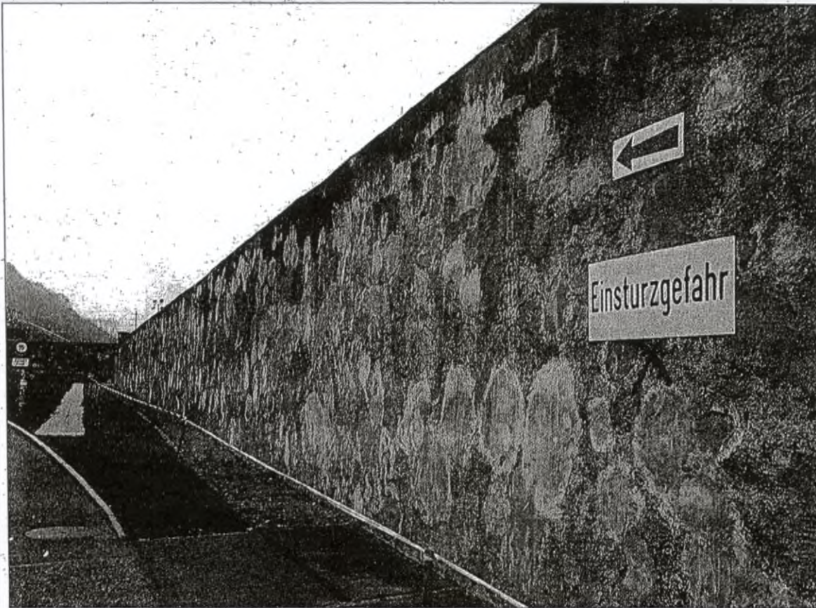
Sicherheit statt Unsicherheit Die einsturzgefährdete Strafanstaltsmauer wird endlich durch einen Neubau ersetzt. HH.
