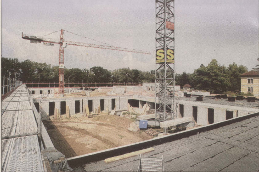
Die neue Klinik für psychisch kranke Straftäter innerhalb des Psychiatricentrums Rheinau steht bereits im Rohbau. Sie kostet rund 23,5 Mio. Fr. und soll bereits in einem Jahr eingeweiht werden. CHRISTIAN BEUTLER
