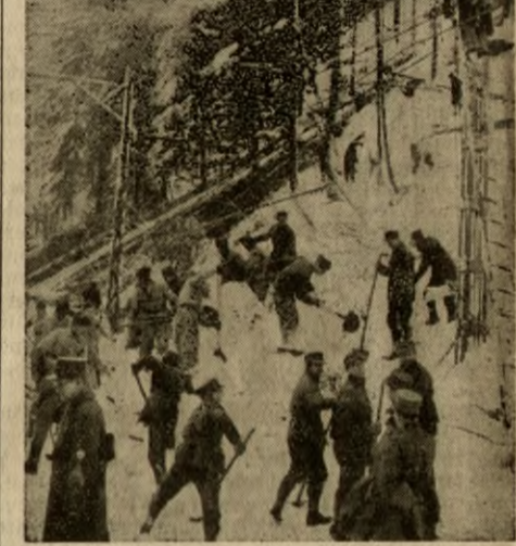
Die Geißberglawine verschüttete zwischen Gurtellen und Amsteg die Gotthardlinie. Zu den Räumungsarbeiten wurde auch Militär beigezogen, wie unser Bild zeigt. ATP VIS 14420
