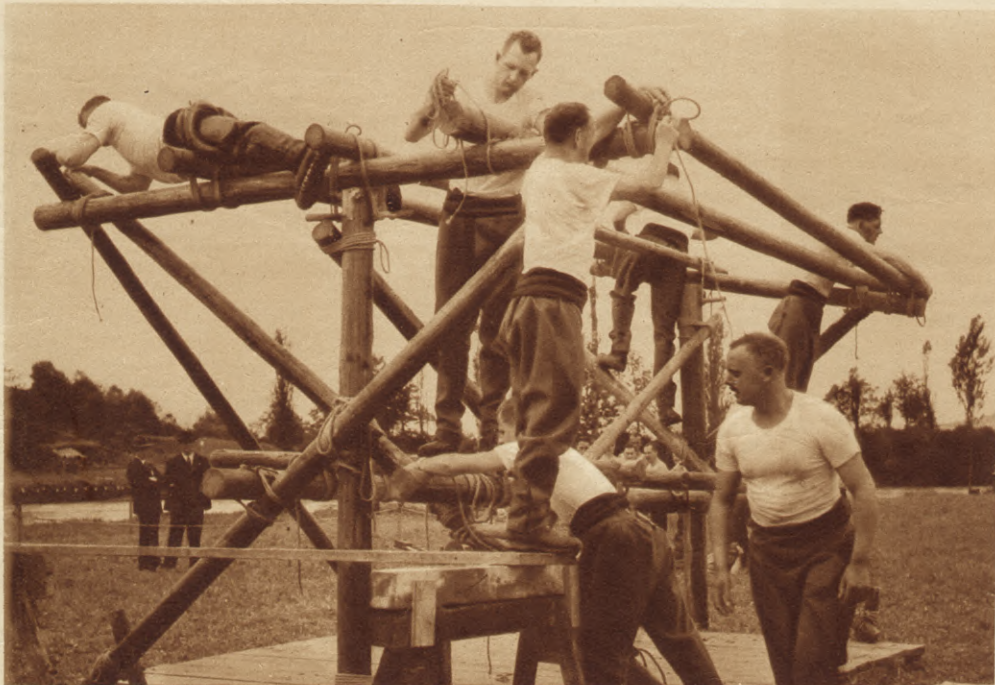
Eine Mannschaft beim Erstellen eines Seilwerkstandes im Wettkampf Schnüren und Seilverbindungen. (Phot. E. Steimle, Zürich)
