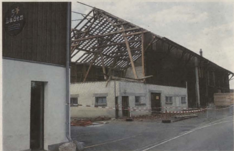
Mit dem Abbruch des Lagerhauses I gibt es Platz für neue Sicherheitsanlagen.
